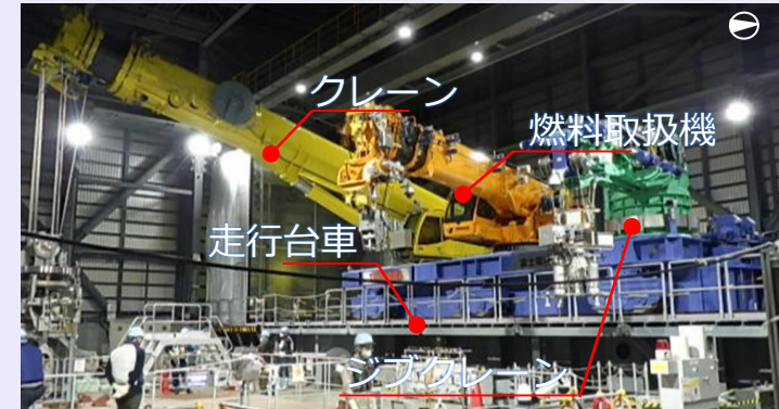
< 2号機燃料取り出し用構台内燃料取扱設備全景 >
