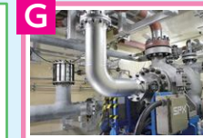
+ 高圧代替注水ポンプ (制御電源不要)
