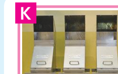
+ 水素処理設備
