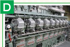
非常用ディーゼル発電機 (各号機3台)
