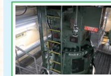
残留熱除去設備 (各号機3台)
