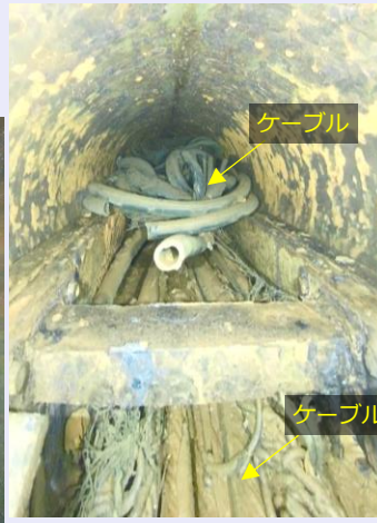
X-6ペネ内部 (PCV内より撮影)
