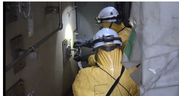
格納容器ベント操作
