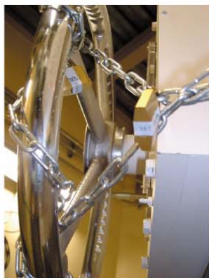
バルブの封印状況
