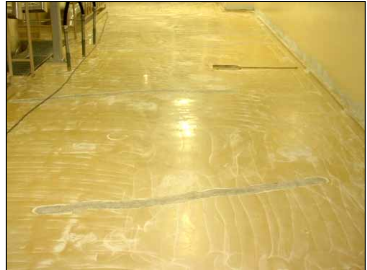
ひび割れ発生部位の塗装をはぎ取り、コンクリート面を露出させる。
