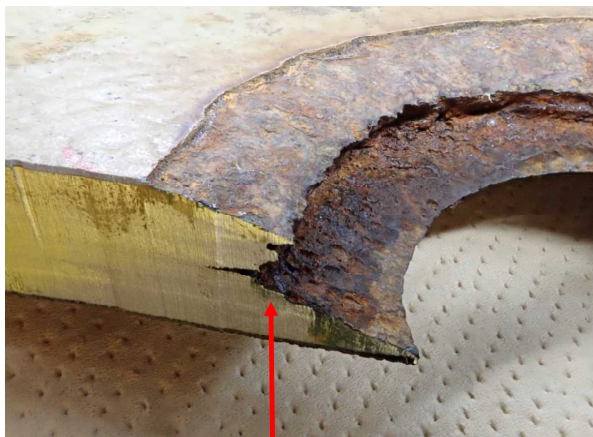
<欠損箇所（破断面）>
