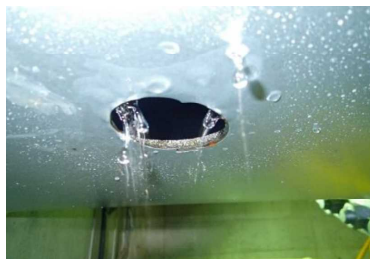
<★欠損箇所（配管外部より撮影：10/20）>
