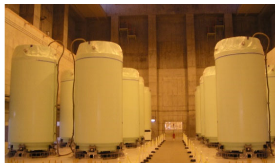
東海第二発電所の乾式貯蔵施設
