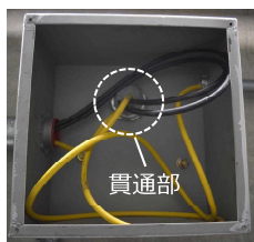
ネジ止めてある金属製箱の蓋を一つひとつ開けて確認
