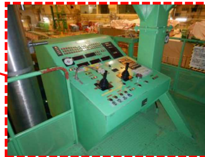
①燃料取替機操作盤
