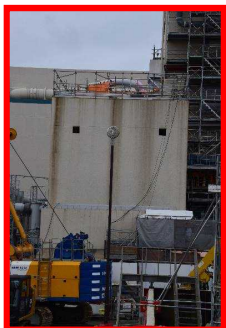
フィルタベント設備 (地上式)
