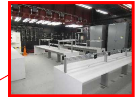
5号機原子炉建屋内緊急時対策所
