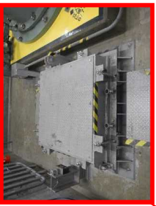
取水槽閉止板
