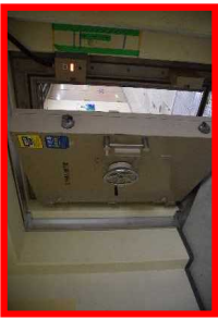
水密扉等の溢水対策 (屋内複数箇所)
