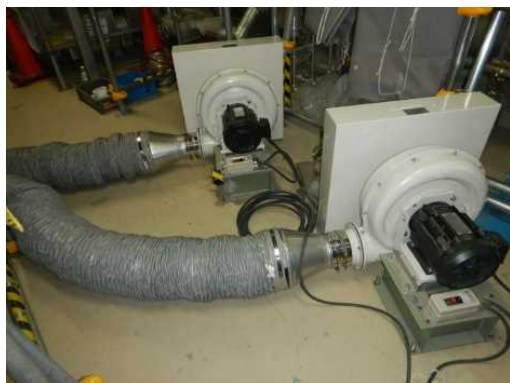
可搬型陽圧化空調機（ファン）
