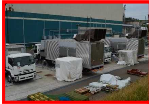
ガスタービン発電機
