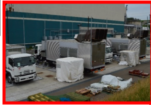
ガスタービン発電機
