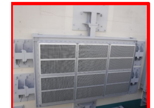
電巻防護ネット (複数箇所)
