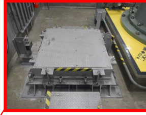
取水槽閉止板
