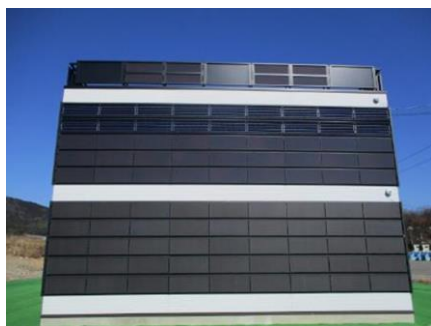
<壁面設置太陽光発電>
