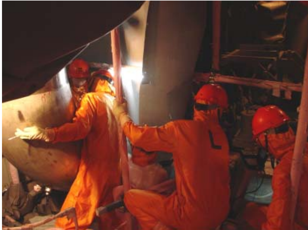
CCDカメラとビデオを使った配管内部の最終確認の状況(2号機)
