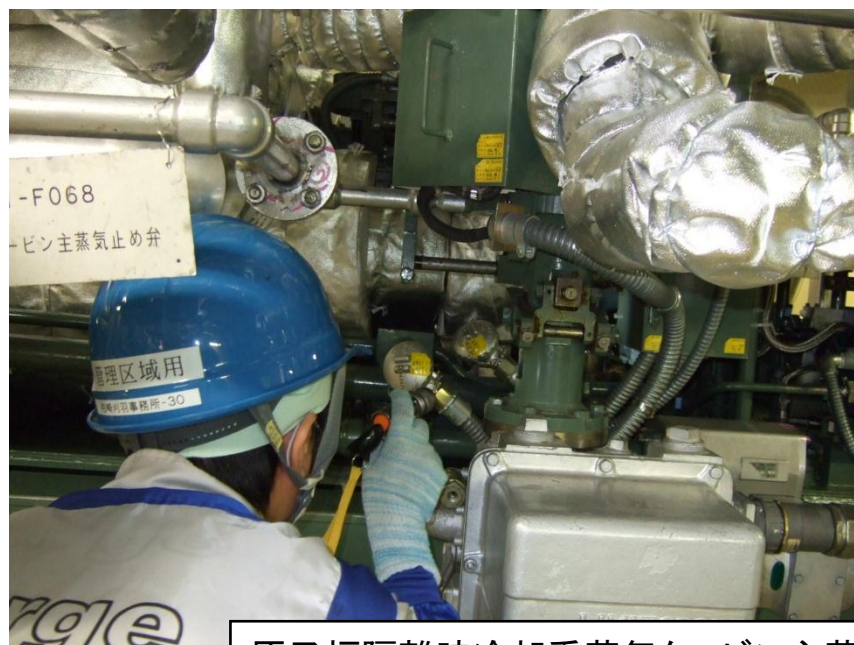
原子炉隔離時冷却系蒸気タービン主蒸気止め弁の確認
