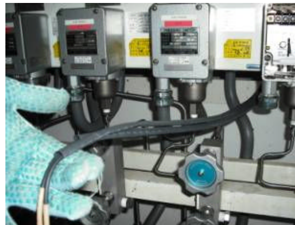
点検中地絡が発生した箇所 (絶縁処置箇所)
