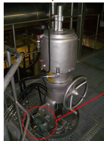
原子炉吸水量調節弁(大弁)
