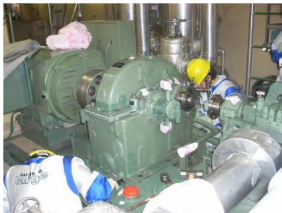
電動駆動給水ポンプの点検(1号機)
