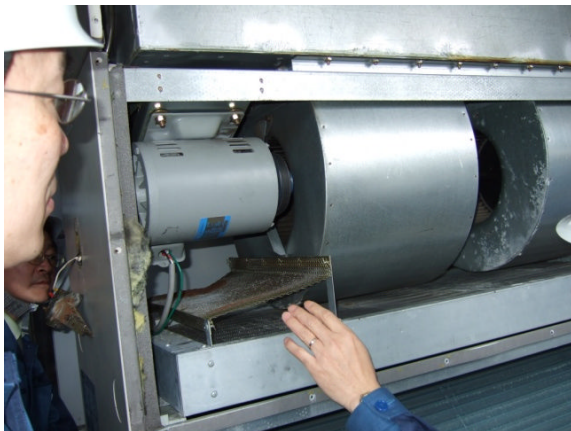
焼損空調機と同型機
