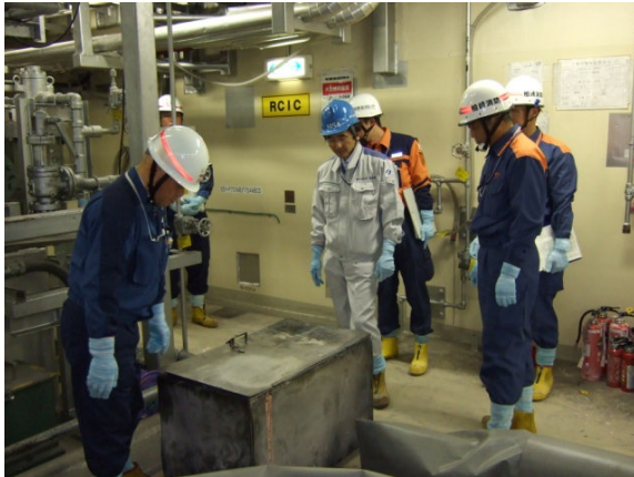
RCIC ポンプ室の現状
