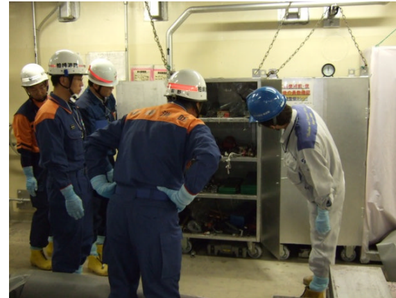
RCICポンプ室工具保管庫
