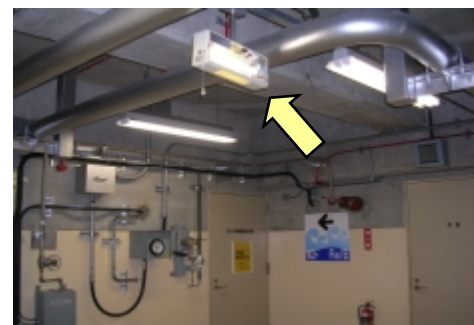
非常灯の破損(7号機) 復旧済み
