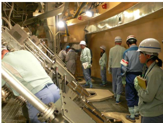
4号機 主蒸気隔離弁
