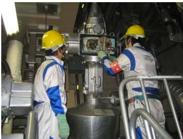
1号機 残留熱除去系弁の点検
