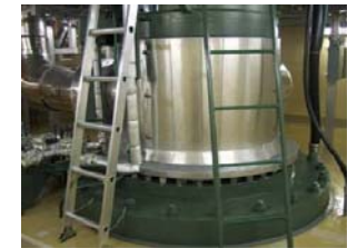
残留熱除去系 ポンプ 等
