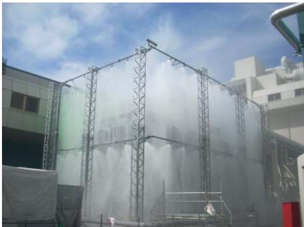
6号機 変圧器スプリンクラー試験
