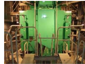
原子炉冷却材 再循環系ポンプ
