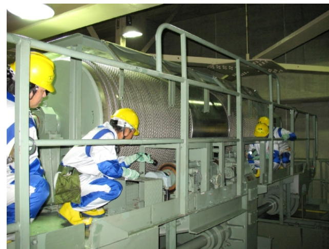
2号機 天井クレーンの点検
