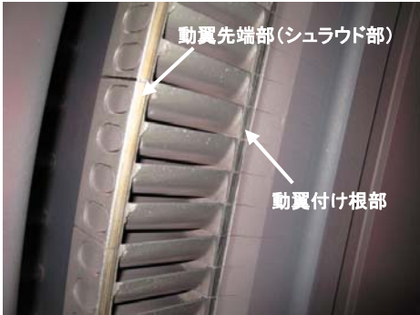
第9段発電機側
