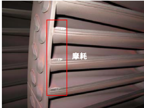
第12段発電機側 湿分離翼部
