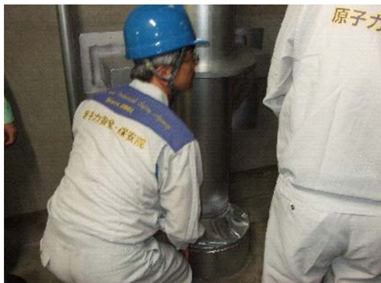
建屋間の相対変位を受ける箇所(不活性ガス系配管)
