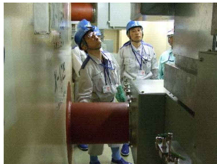
解析の結果裕度の少なかった設備(電気配線貫通部)
