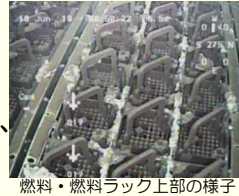
燃料・燃料ラック上部の様子
