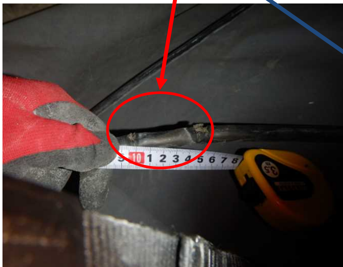
ケーブル損傷の状況
