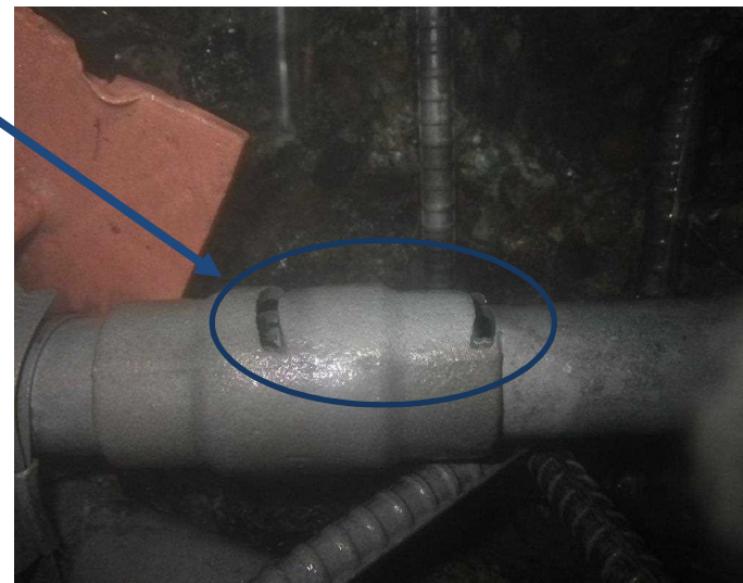
電線管損傷の状況
