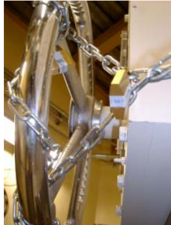
バルブの封印状況
