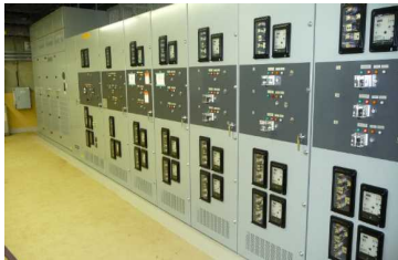
1号機 電源盤(P/C 1C-1)据付後
