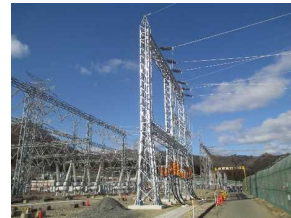
新福島変電所
