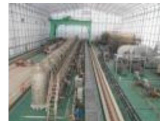
(高性能多核種除去設備)
