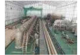
(高性能多核種除去設備)
