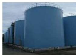
ALPS処理水タンク (溶接型タンク) 新設・リブレース (Bエリア)
