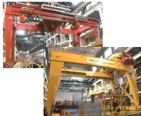
3号機燃料取扱機(上)クレーン(下)
