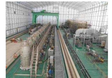
(高性能多核種除去設備)
