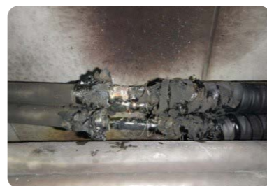
熱で溶けたケーブルの接続部
