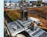
小水力発電施設
