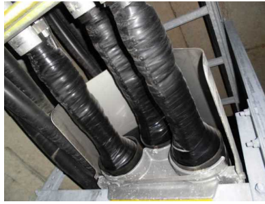
<66kV GIS～LStr6SB間の接続部>
