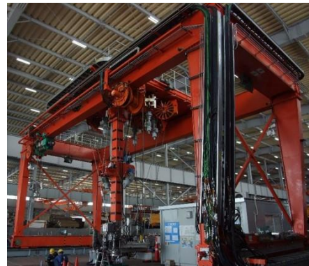
3号機燃料取扱い機
