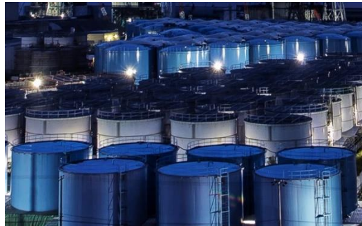
処理水貯蔵用タンク
