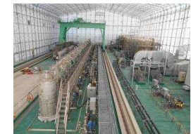
(高性能多核種除去設備)
