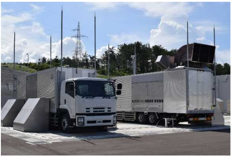
設置後イメージ (写真は同型の空冷式ガスタービン発電機)
