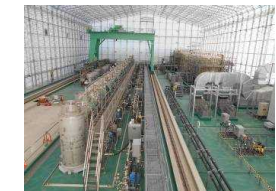
(高性能多核種除去設備)
