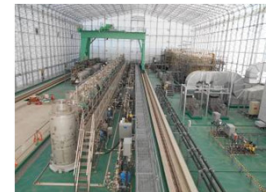
(高性能多核種除去設備)
