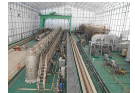
(高性能多核種除去設備)
