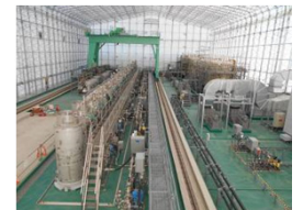
(高性能多核種除去設備)
