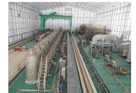
(高性能多核種除去設備)
