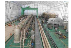
(高性能多核種除去設備)
