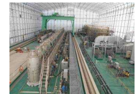
(高性能多核種除去設備)
