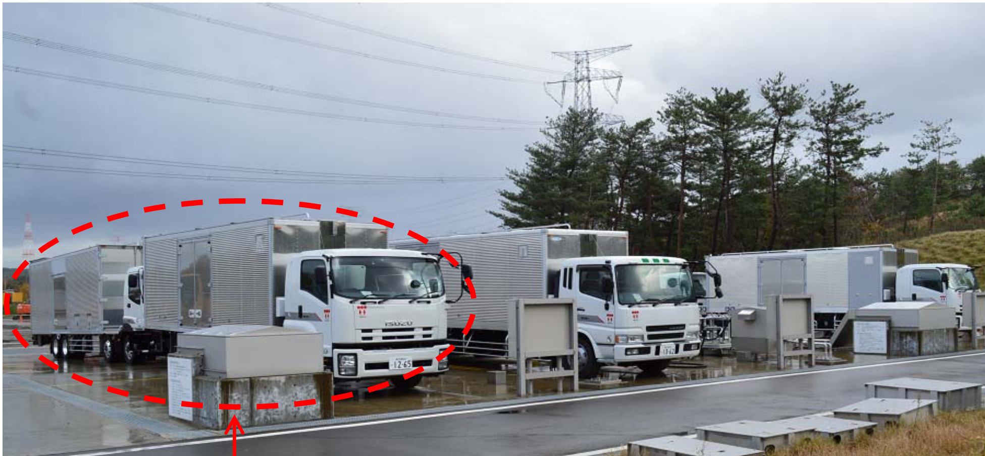
追加配備したガスタービン発電機車
