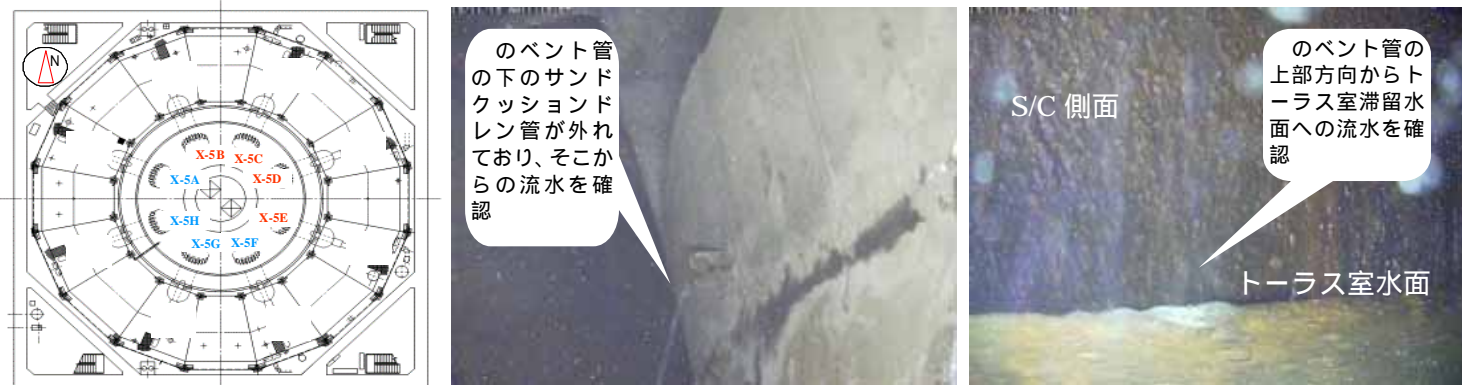
図8：1号機 サンドクッションドレン管及びベント管上部からの漏水状況
