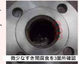
微小なすき間腐食を3箇所確認 供給ポンプ1 出口配管フランジ C系統腐食対策有効性確認状況
